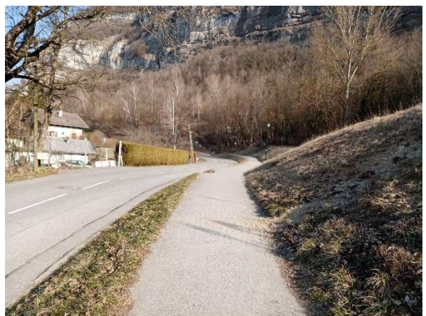
Voie verte peu large (1,5m) avec de nombreux défauts dans la chaussée - Sillingy
